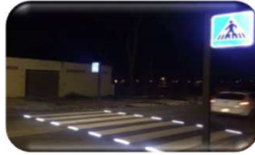
Pasos de peatones con luces catadióptricas en el firme con detección de presencia
